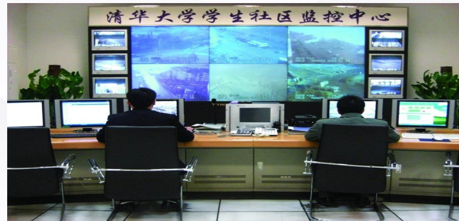
宿舍安防监控平台
